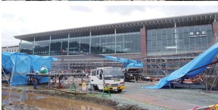
年内完成へ工事が進む駅西口の駅前広場。主にバスやタクシーの乗車場を整備するほか、観光・団体バスの起点として期待される
