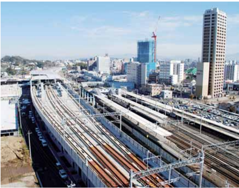
▲在来線と平行して長く延びる九州新幹線「熊本駅」。写真中央のクレーンで建設中のビルは熊本駅前東A地区の再開発ビル「くまもと森都心」。右端は27階建ての「東横イン熊本駅前」
