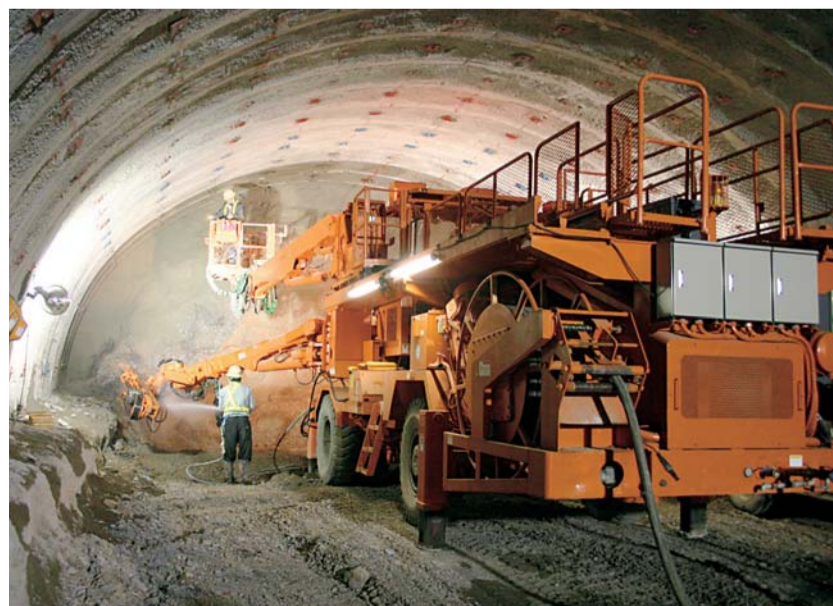
▲トンネルの最先端部で進む「ドリルジャンボ」による掘削工事。昼夜24時間態勢で行われる
