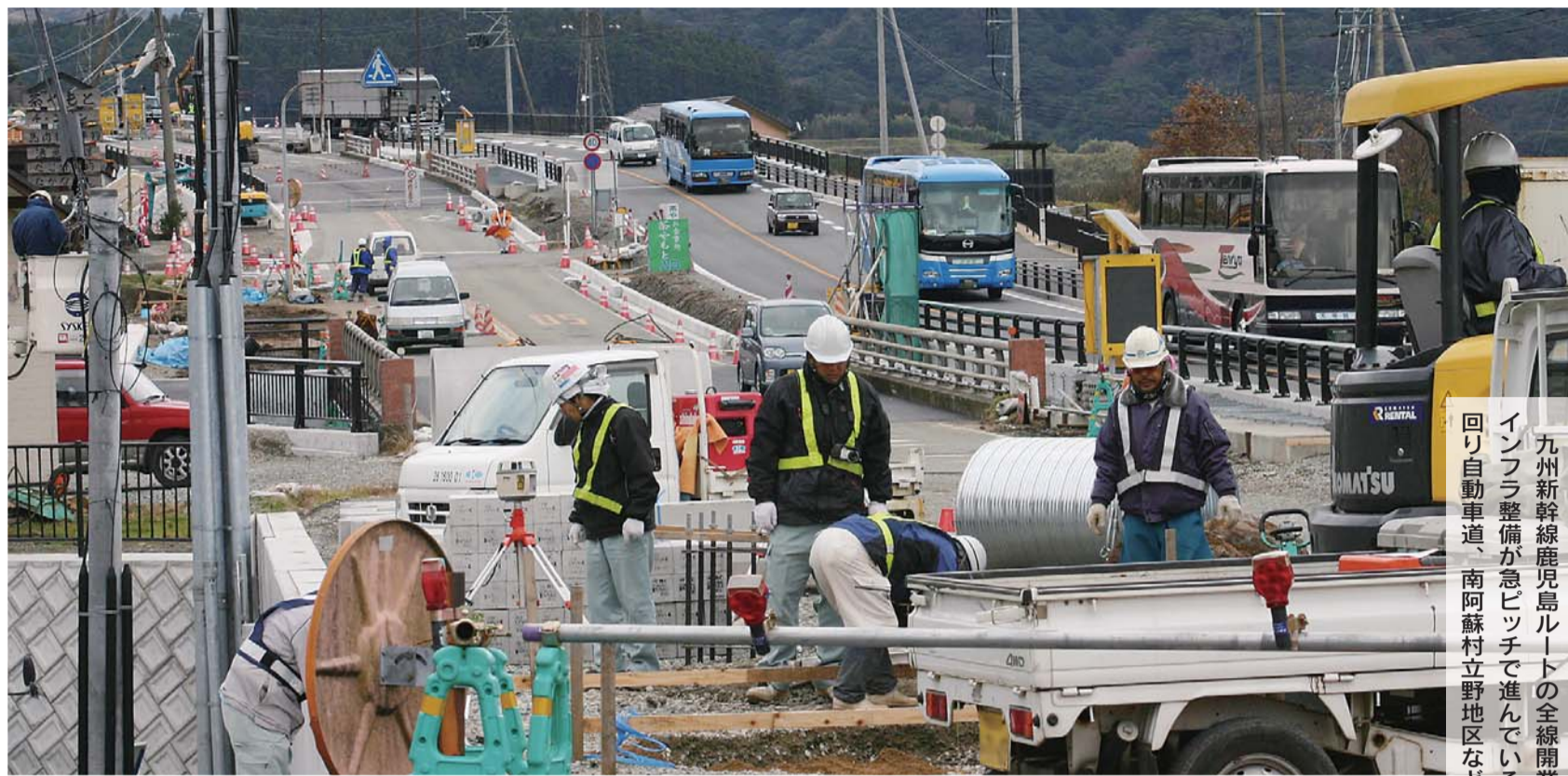
▲豊肥線・立野駅付近では舗装工事に向けた工事が進む
