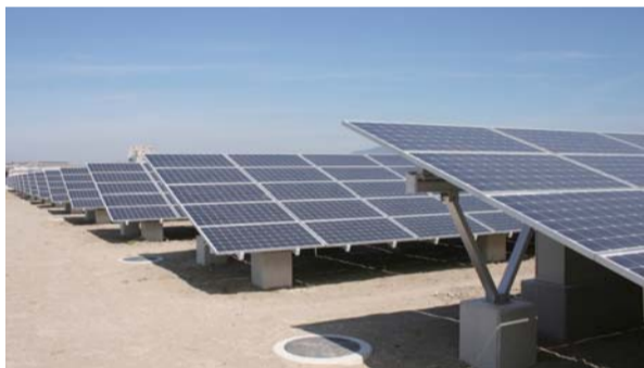
太陽光パネルは20度の角度で設置。パネルを支えるアルミ製の架台はトステムとNTTファシリティーズが共同開発し商品化、今後はメガソーラー発電施設に販売を計画している
