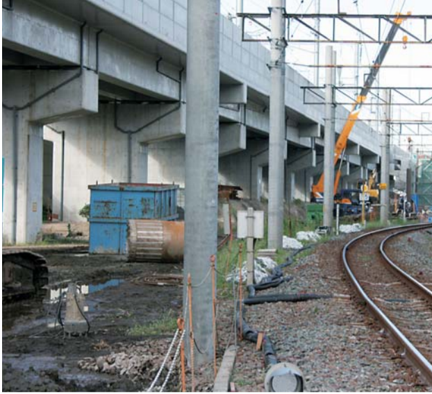
▲熊本市春日1丁目付近で進む在来線の高架工事。完成は16年頃を見込む
