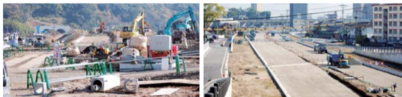
▲熊本市池上地区では西回りバイパスと接続するバイパス工事が急ピッチで進んでいる
