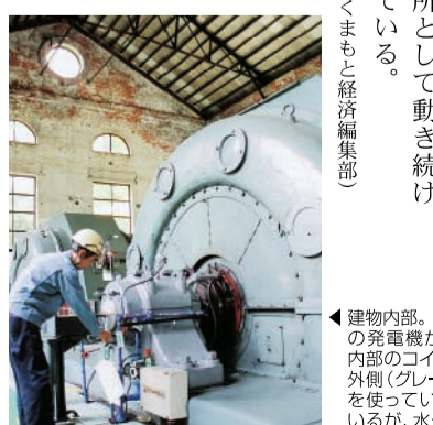
▲建物内部。1号機(手前)と2号機(奥)の発電機が24時間稼働する。機器内部のコイルなどは更新しているが、外側(グレー部分)は一部大正期の物を使っている。現在は無人化されているが、水俣製造所動力部水力課が定期的にメンテナンスしている
