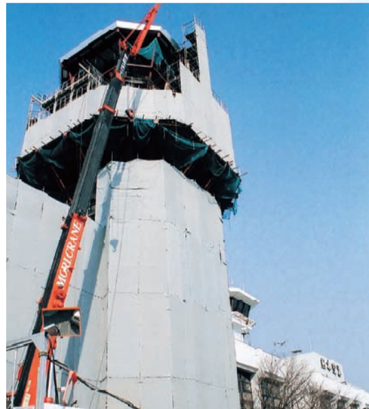
◀建設中の新空港事務所棟は、地上5階建てで、07年3月完成予定。管制機器の搬入、整備のための移転は08年3月頃となる見通しだ。新管制塔の高さは37mで、現在の管制塔(25m、写真後方)を上回る
