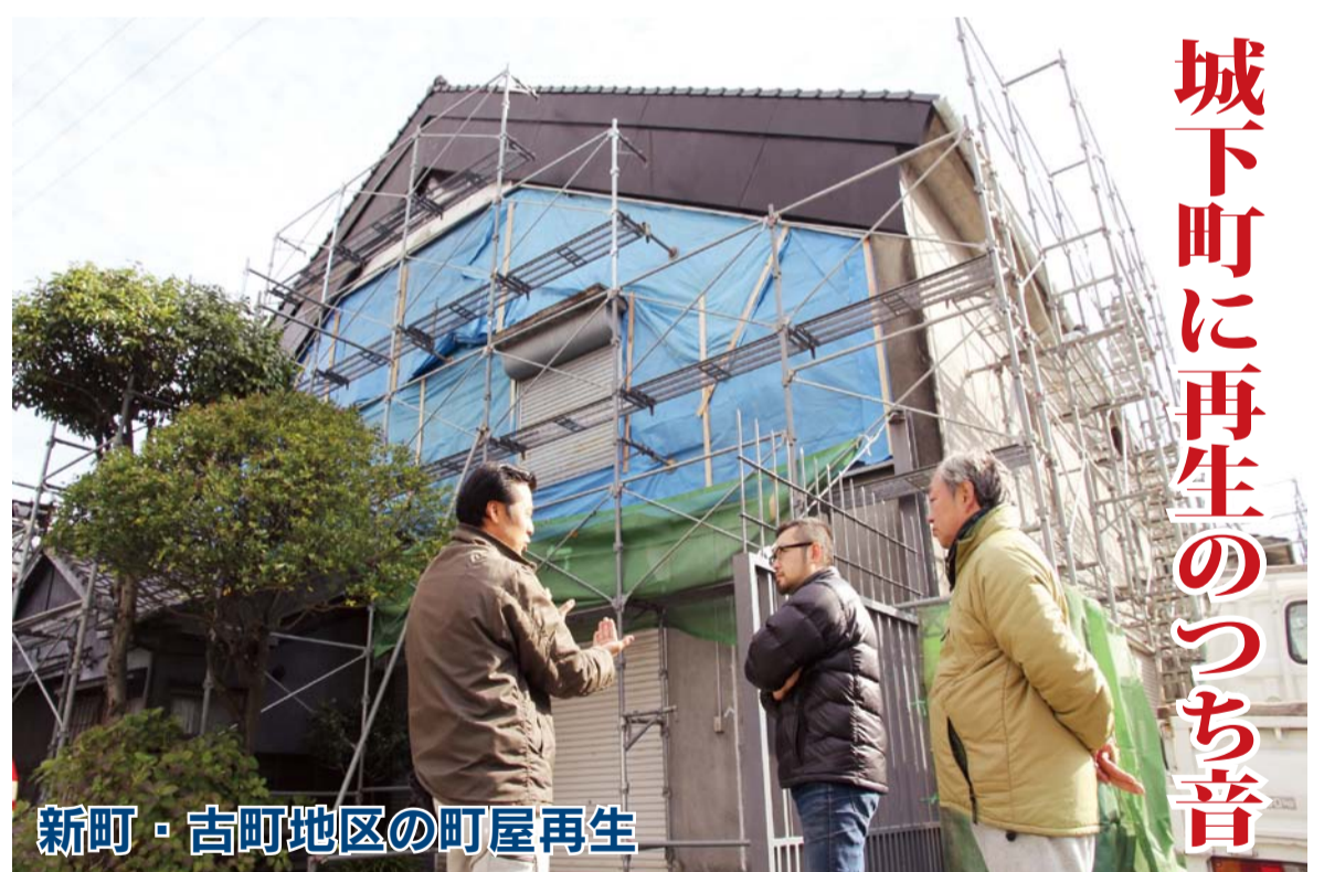
▲足場が組まれた早川倉庫の母屋前で工事の綿密な打ち合わせ。左から施工する宮本建設 (中央区新町) の宮本茂史専務、祐三さん、父で代表の早川礼三さん (63歳)。宮本さんは新町古町町屋保存会の会長を務める。工事費用は400万円、うち半分を市が助成する
