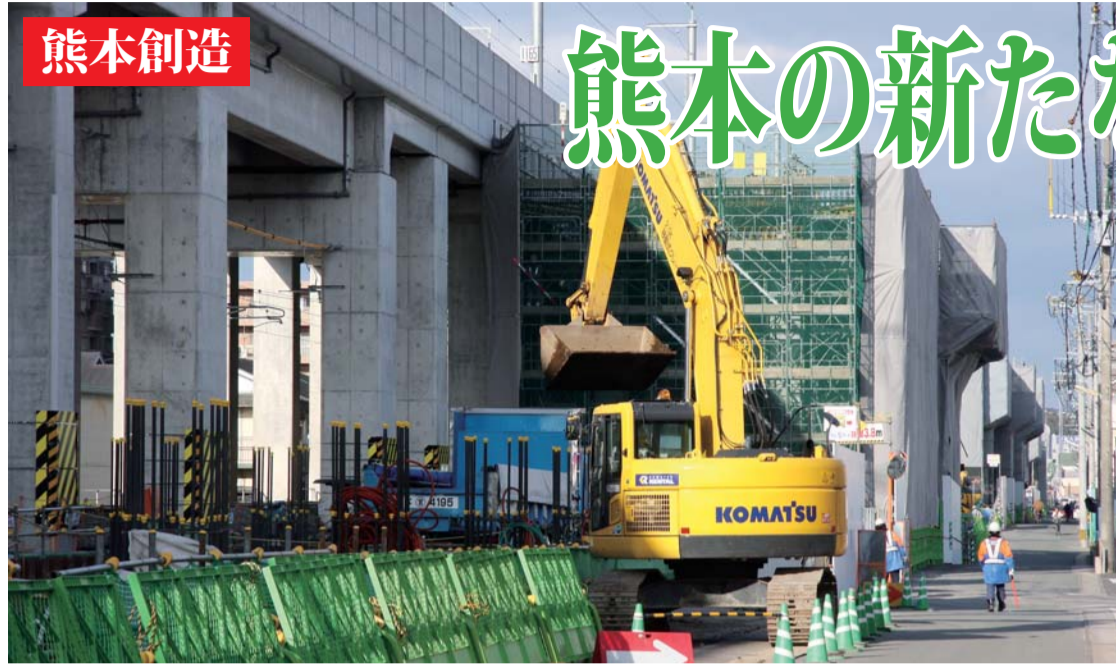
▲2018（平成30）年頃の完成を目指し工事が進む鹿児島本線の連続立体交差工事。完成後は東西方向の移動もスムーズになる（熊本市西区花園1丁目で）
