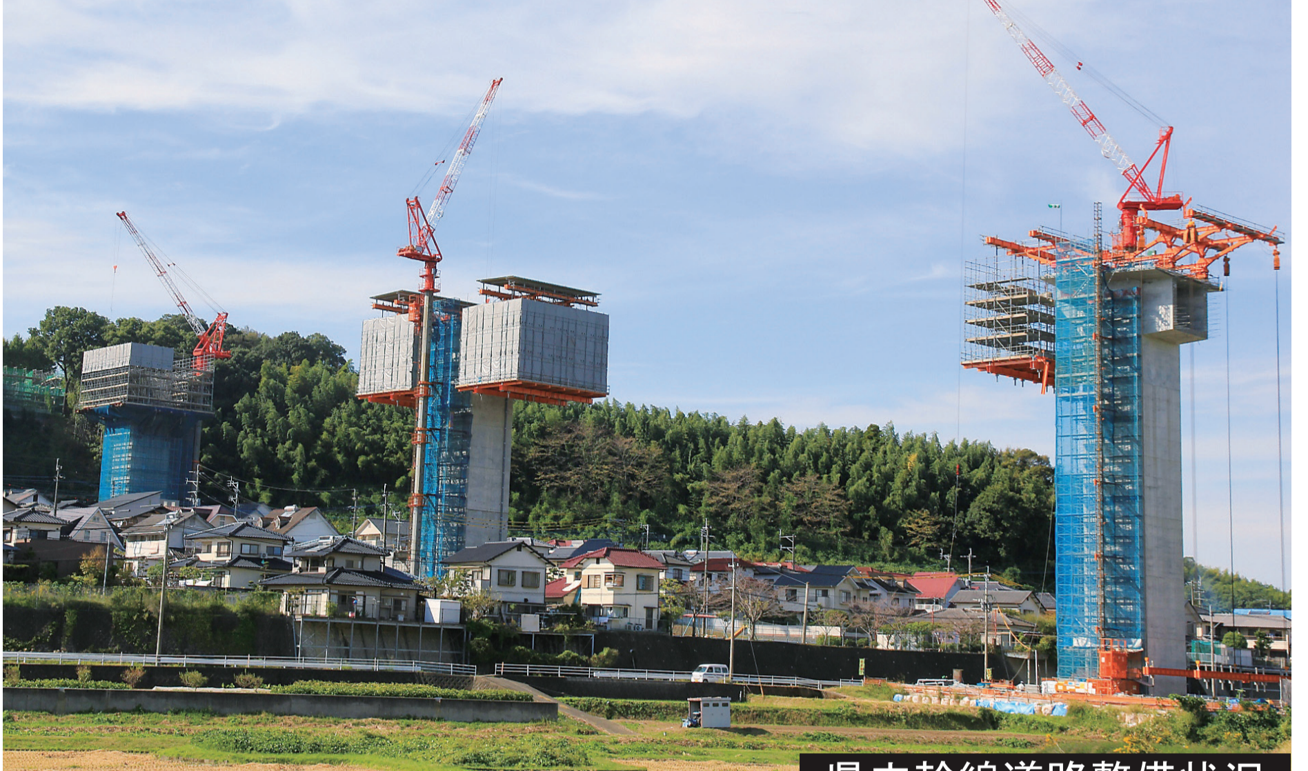
▲須屋交差点から北区四方寄町の国道3号まで1.8kmの14年度供用へ、上部工工事が本格化している国道3号熊本北バイパスの「石田橋」(延長383m)。3~4mずつコンクリートを打設しながら桁を延ばす工法が採用されている。四方寄町の葉山団地付近
